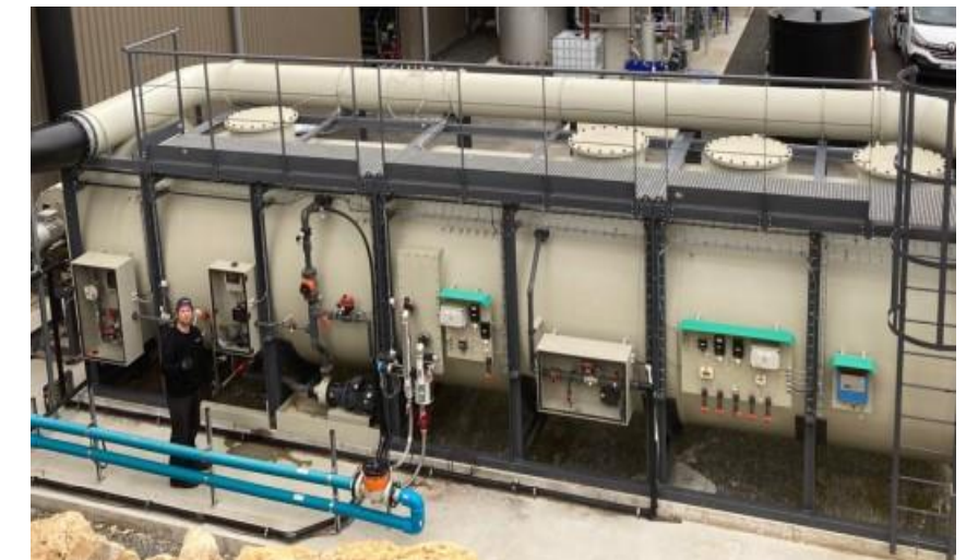
Exemple de traitement de l'air
